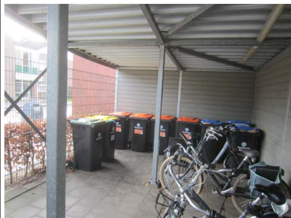
Containers in de fietsenstalling (grenzend aan de openbare weg). Containers weghalen of ruimte afsluiten
